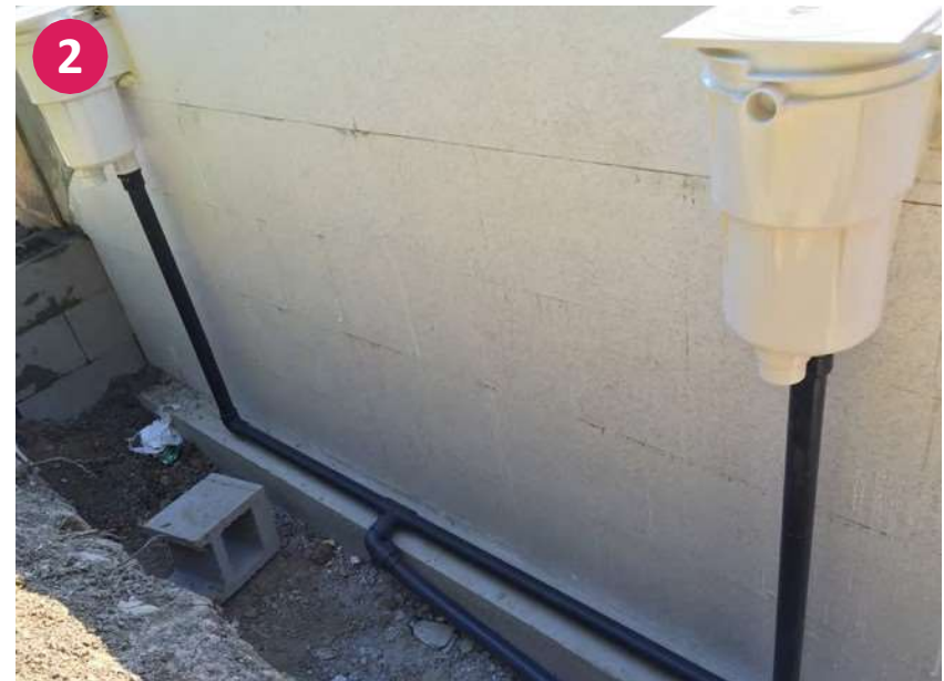
Potrubí pro 2 skimmery
