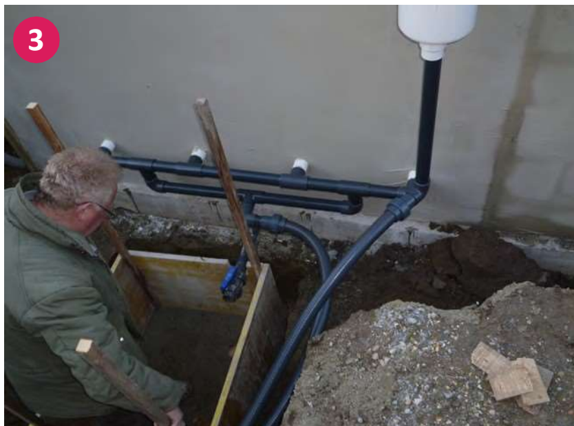
Potrubí trysek, skimmeru a podlahové vpusti
