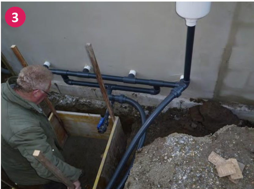
Potrubie trysiek, skimmera a podlahového vpustu
